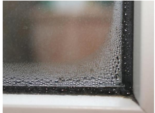
Symbolbild: Beschädigte Dichtung mit Feuchtigkeit schaden
