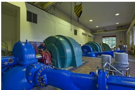
Abbildung 5: Maschinenhaus eines Speicherkraftwerkes www.energiesdienst.de
