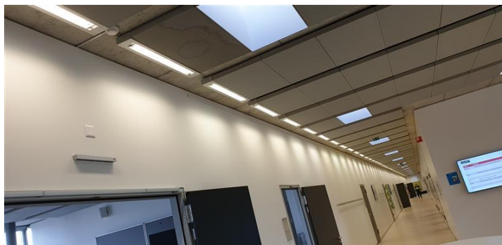
Abbildung 3, Leuchtstoffröhre im Gang der MSW, QUELLE: eigenes Foto
